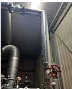
保温対策をしたボイラ
