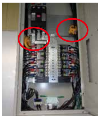
計測器設置状況
