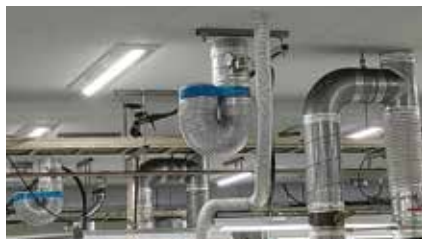
局所排風機のダクト
