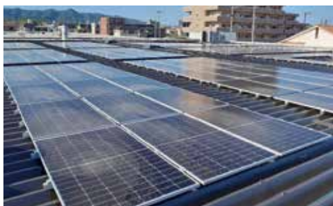
工場建屋の屋根に設置した太陽光発電設備
