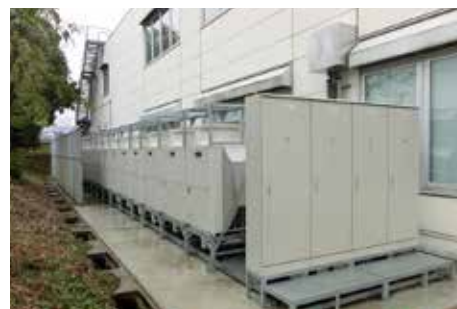
更新した EHP 空調機
